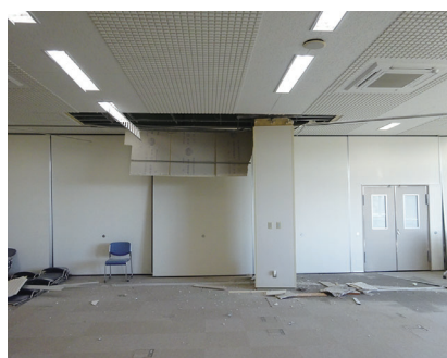
▲会議室天井より雨漏り
