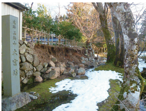
崩れた石垣(石動山地内)
