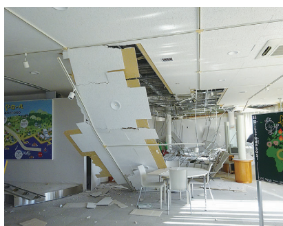
▲2階展示室天井落下
