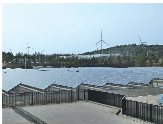
志賀町若葉台にある志賀太陽光発電所（北陸電力㈱） (後ろに見えるのは福浦風力発電所〔左の写真〕)
